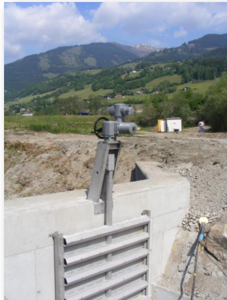
Sperrenbauwerk mit Schütz und automatischer Antriebseinheit
