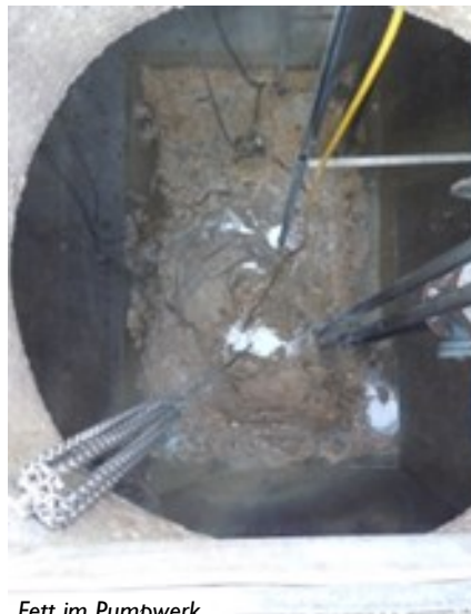
Fett im Pumpwerk
